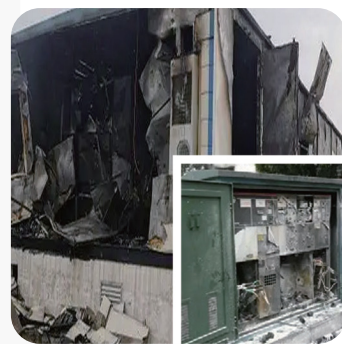
开关柜火灾风险
